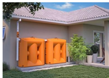
Coleta águas pluviais (Fluxo/UFRJ).
